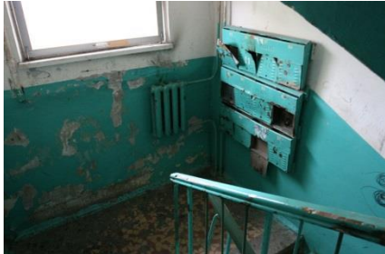
Подъезды не ремонтируются!
